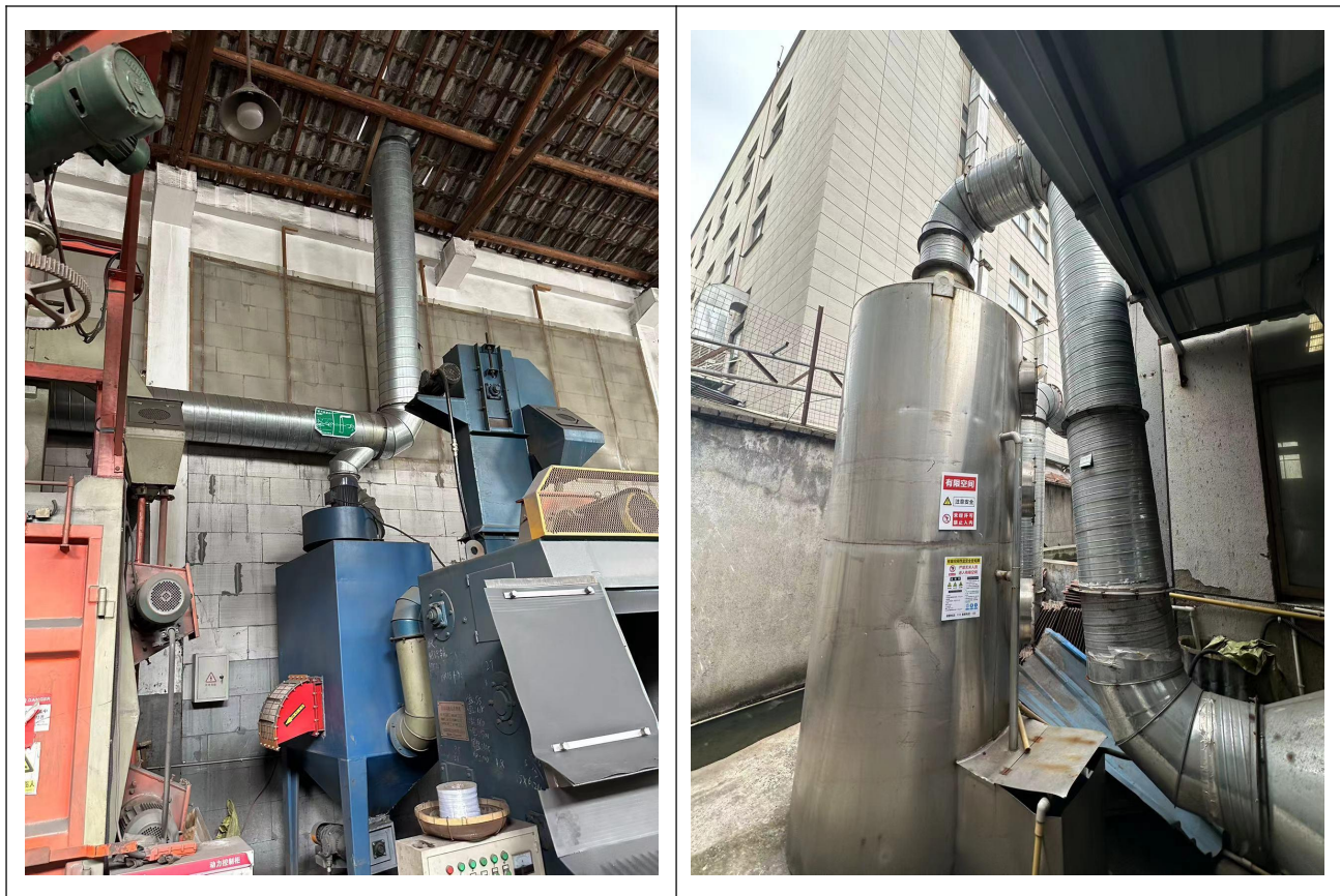
附图 1：废气处理设施
