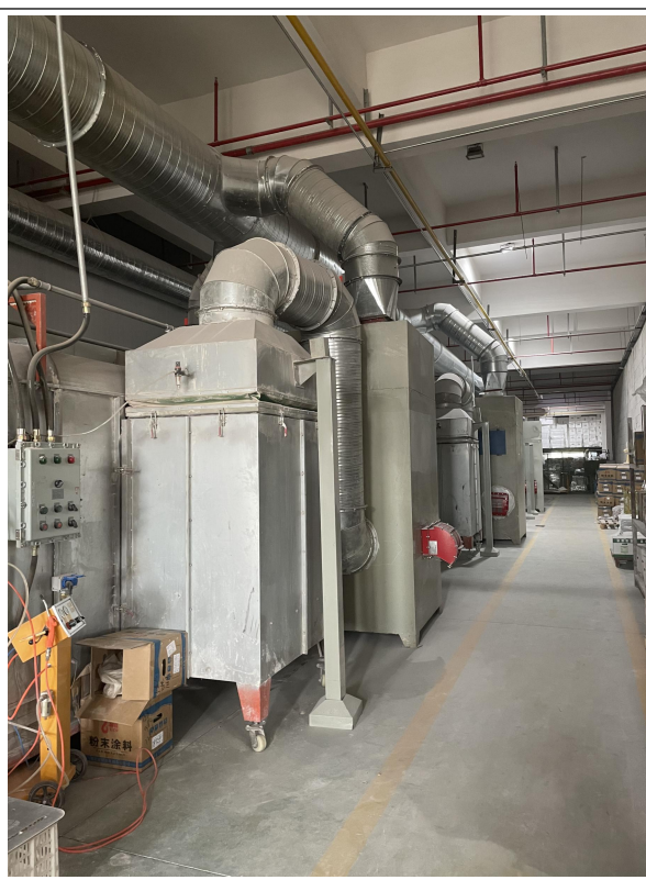
喷塑废气处理设施
