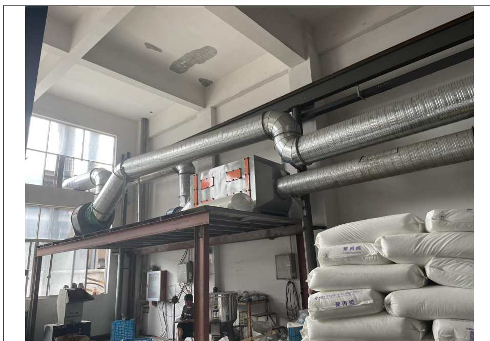
注塑废气处理设施
