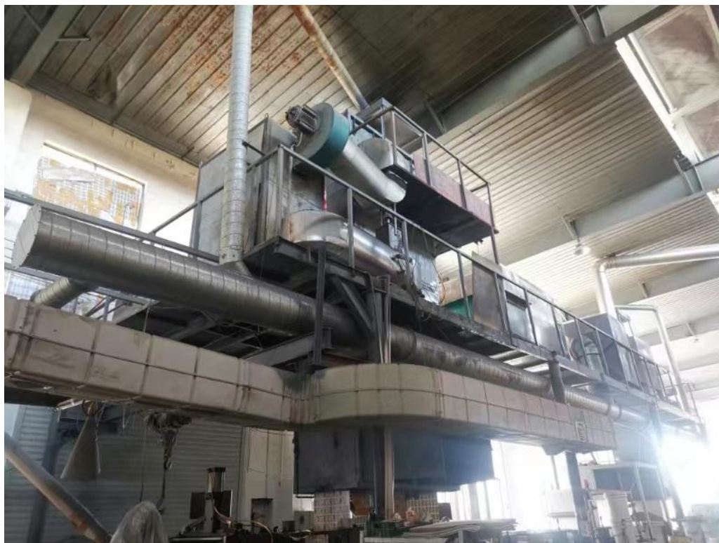
附图 1：废气处理设施
