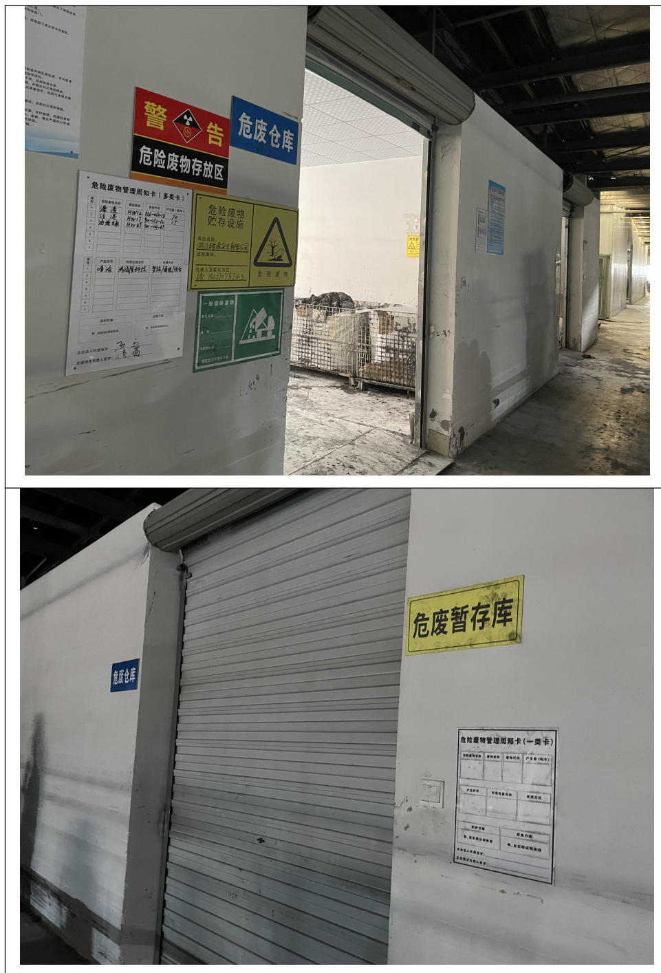
附图 3：危废暂存间
