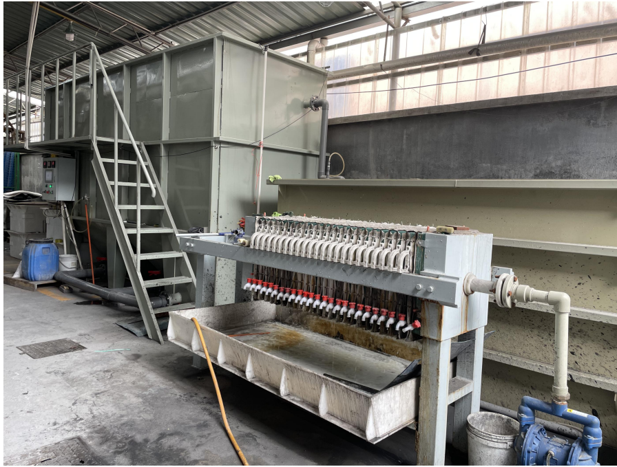
附图 1：废水处理设施
