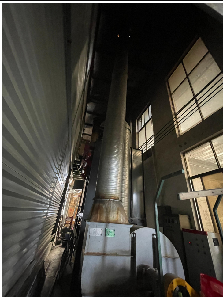
压铸熔化废气处理设施
