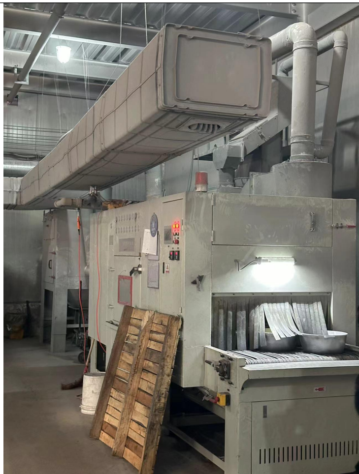
喷砂废气处理设施
