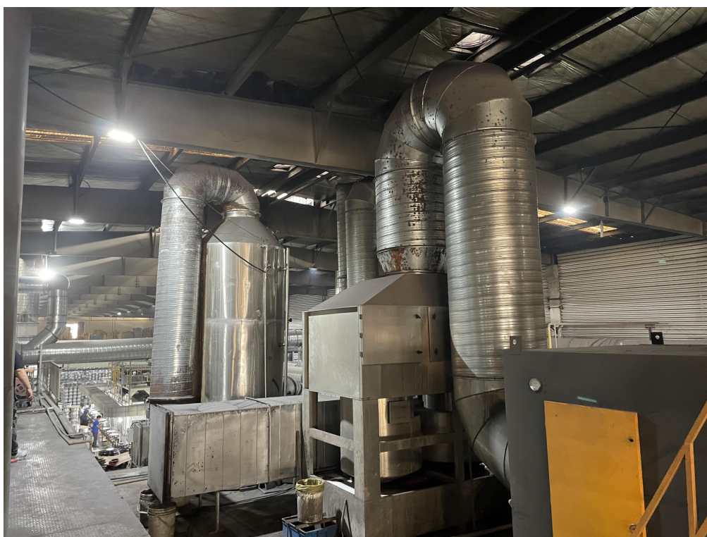
涂装废气处理设施
