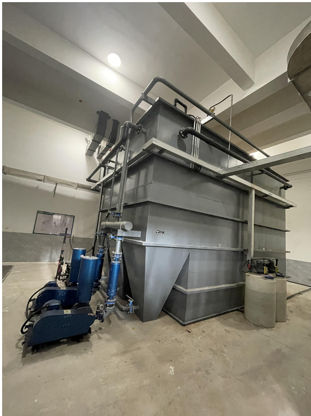
附图 1：废水处理设施
