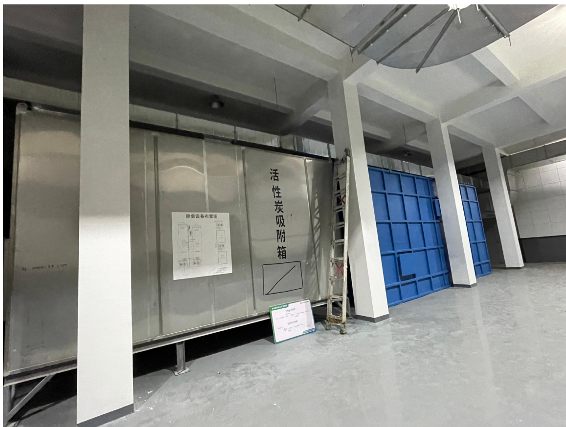
附图 2：废气处理设施
