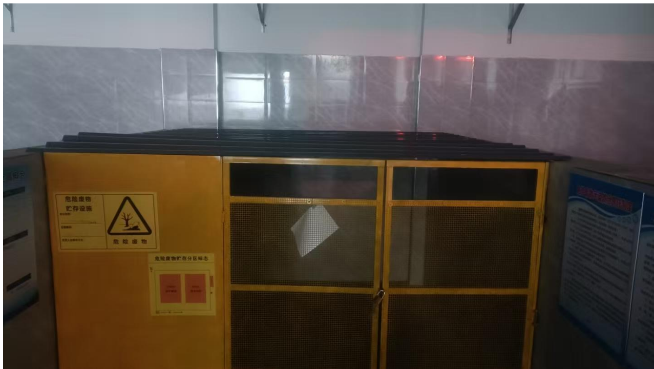
附图 3：危废暂存间
