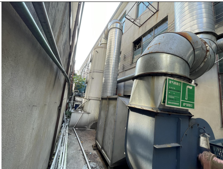
注塑废气处理设施
