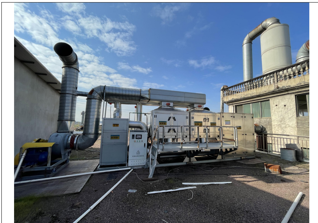
涂装废气处理设施
