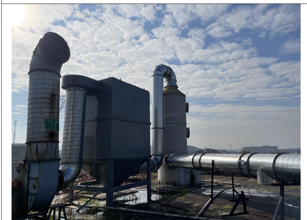
熔化压铸、天然气燃烧废气处理设施
