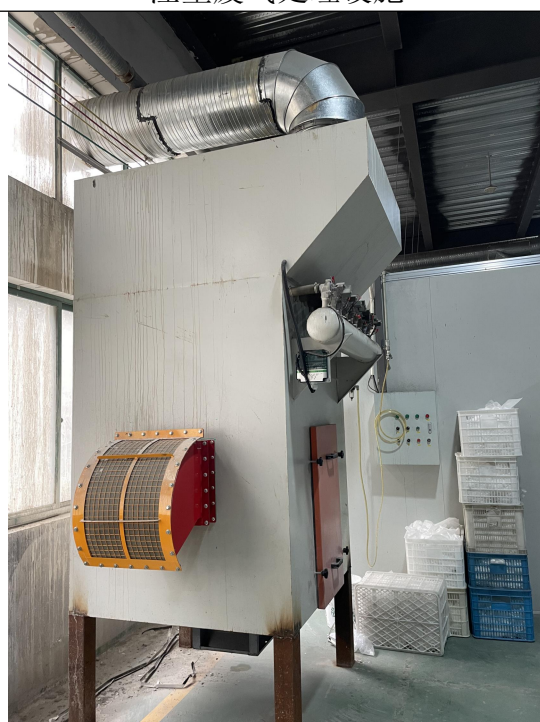
喷塑废气处理设施
