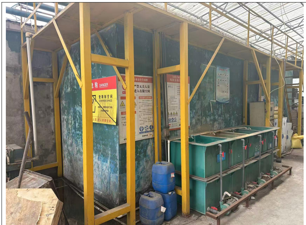
附图 1：废水处理设施
