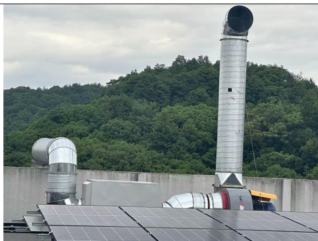
注塑废气处理设施
