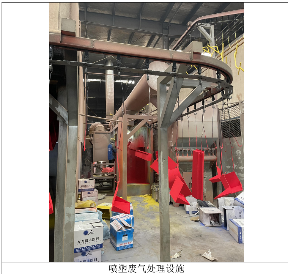
附图 1：废气处理设施
