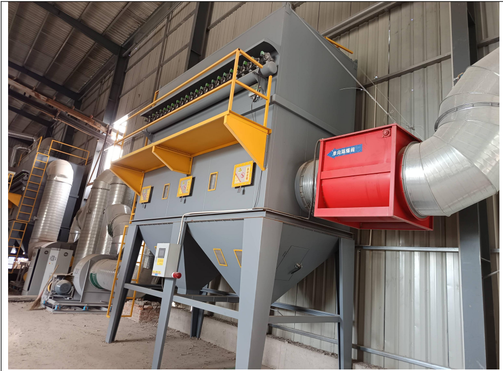
破碎处理设施
