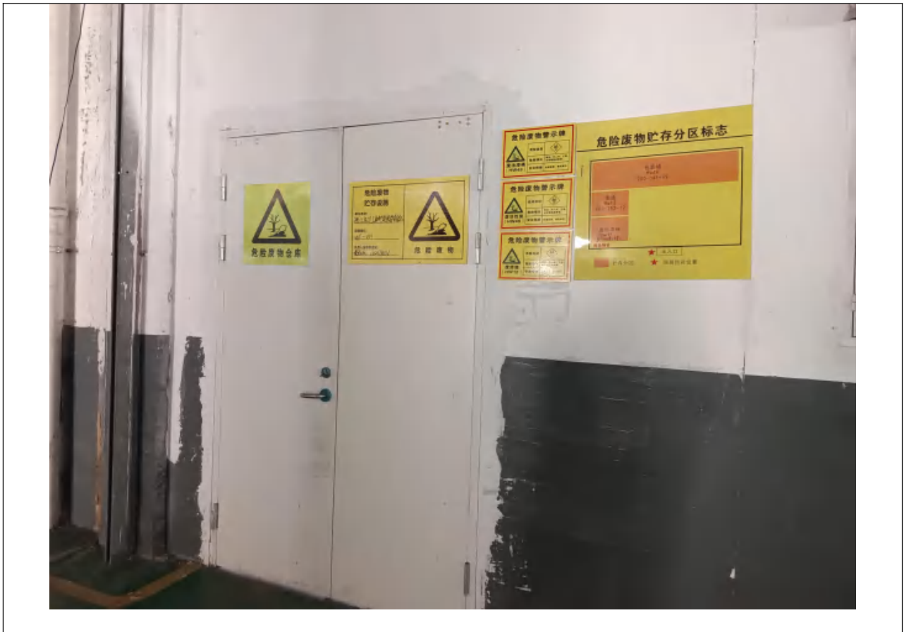
附图 2：危废暂存间
