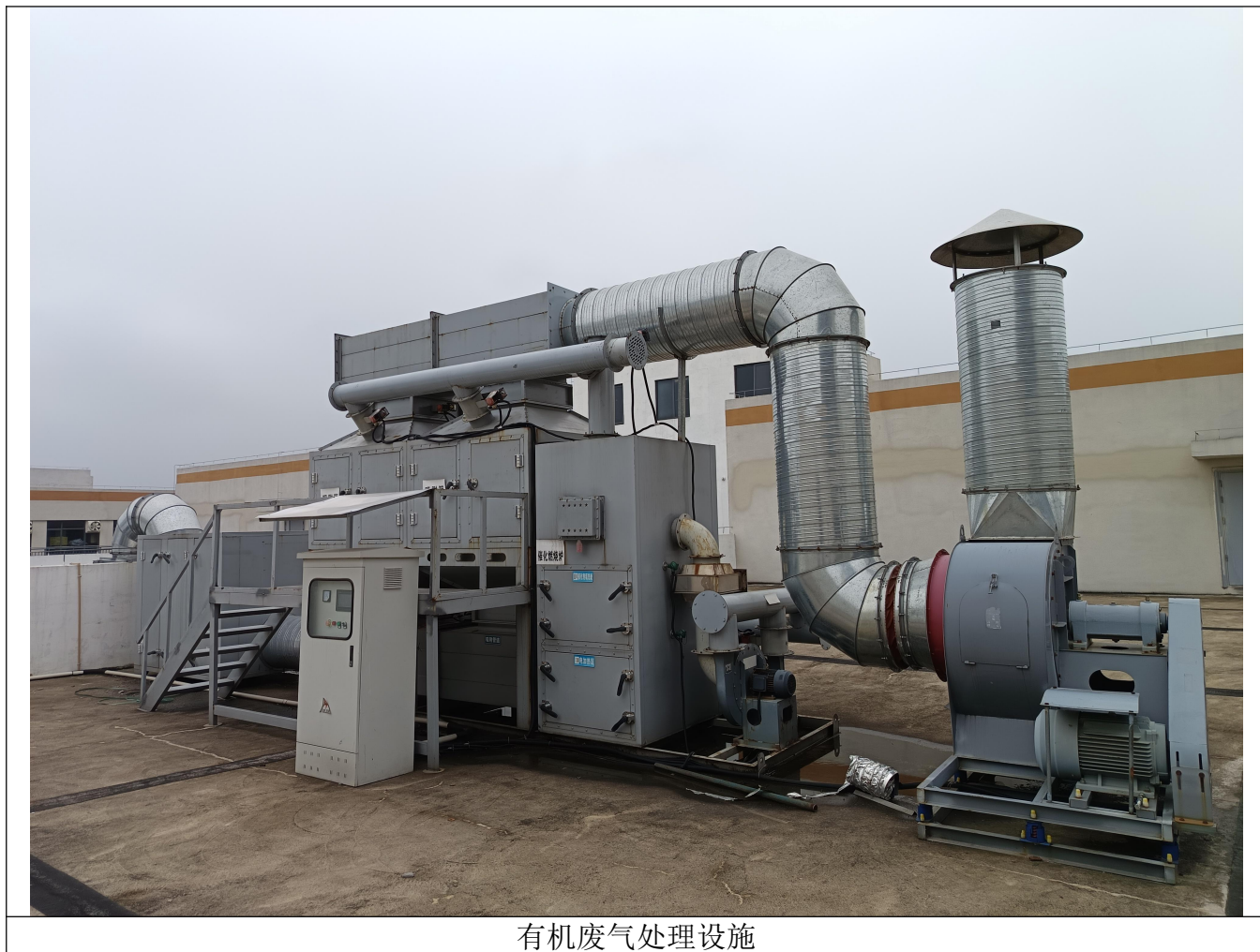
附图 1：废气处理设施
